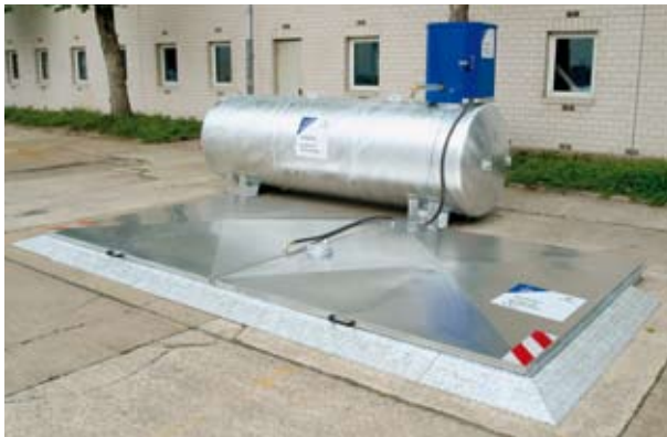
Die geschlossene Eigenverbrauchs-Tankanlage
