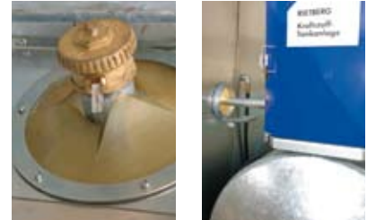
Befüllung des Lagerbehälters, Grenzwertgeber ist Zubehör (oben); Durchführung für Füllstutzen (mitte)
