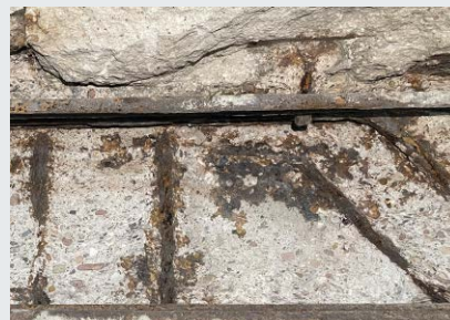
Beispiel für Betonkorrosion
