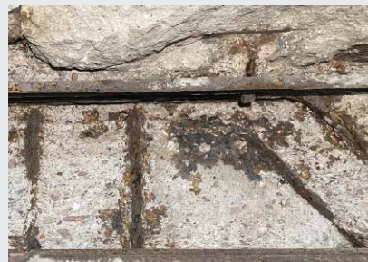
Beispiel für Betonkorrosion
